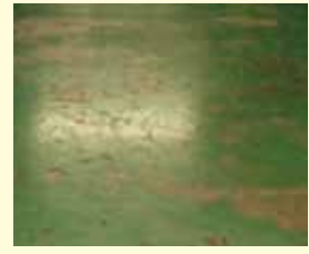
塗装が剥がれた床材
