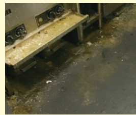
調理器具前の堆積油汚れ
